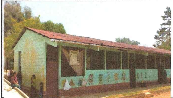
Foto 4. Se observa el termino de vida útil del entechado de estas aulas.
