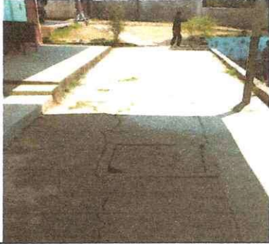
Foto 1. Se observa la carencia de corredor de la Dirección. Y las malas condiciones del piso.
