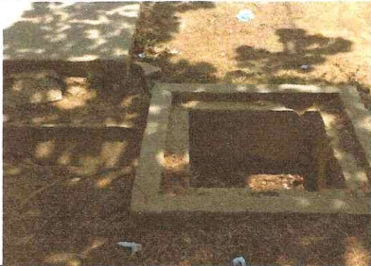
Foto 3: Se observa el abandono de las cajas de aguas de lluvia y el mal estado de cuneta.
