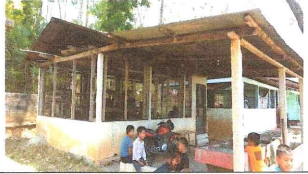
Foto 2. Se observa el deterioro del techo de la cocina.
